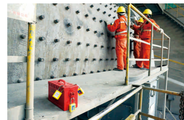
武穴公司磨检修时进行隔离加锁 Wuxue Co. carry out isolation & lockout before maintenance
