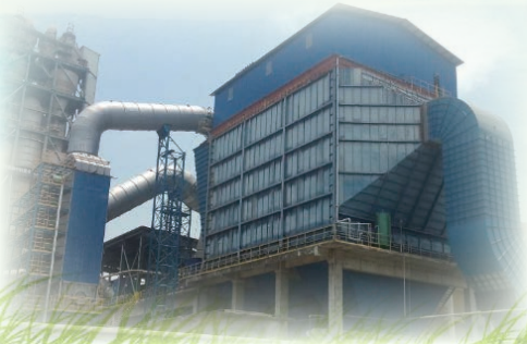
华润水泥(平南)有限公司3#窑头袋式除尘器
